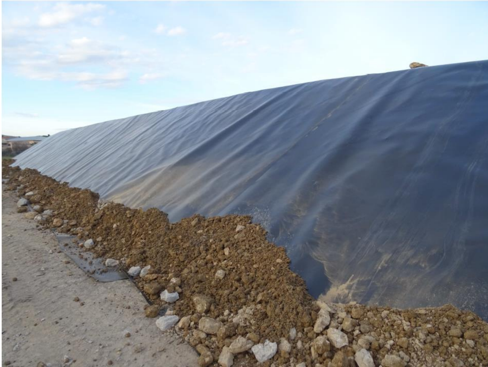
Figure 5 : Photographies du stockage de terres non inertes (Source Photographique : Eiffage)
